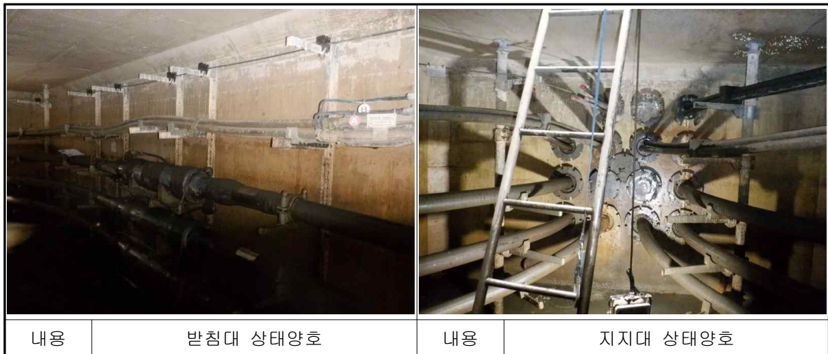
【사진 7.72】 부속 및 부대설비 현황
