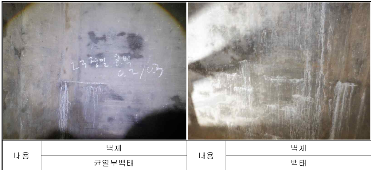
【사진 7.46】 맨홀 내부 주요 손상
