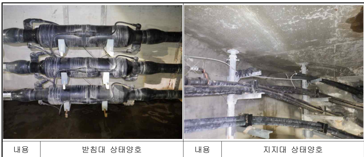
【사진 7.16】 부속 및 부대설비 현황
