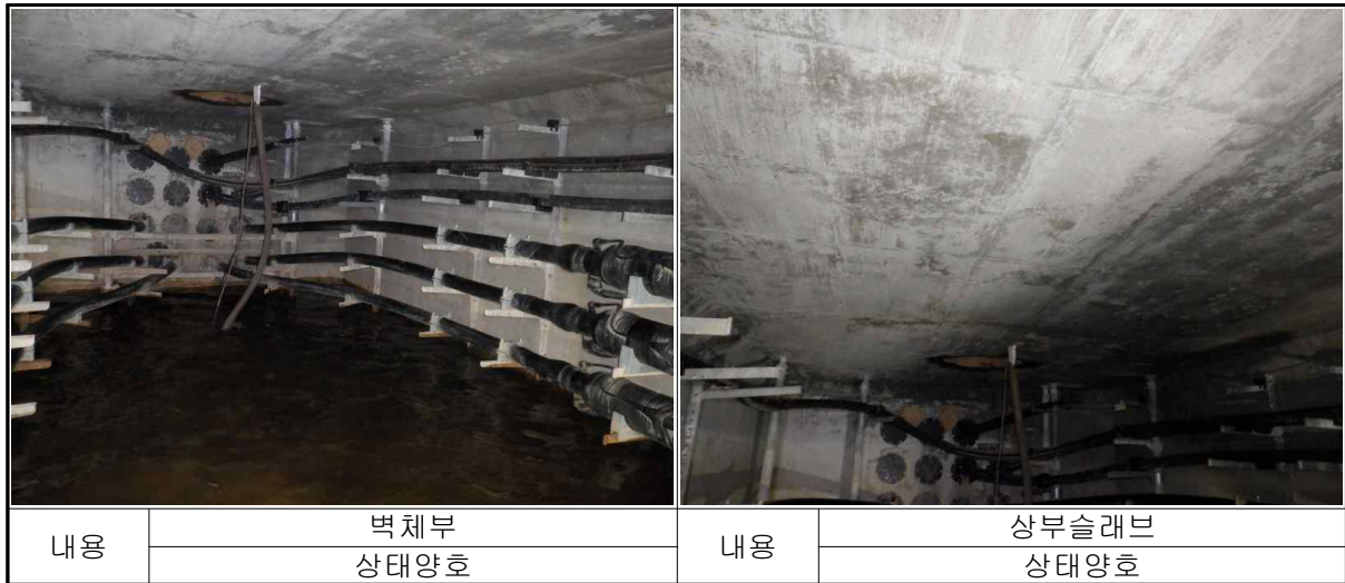
【사진 7.14】 맨홀 내부 주요 손상
