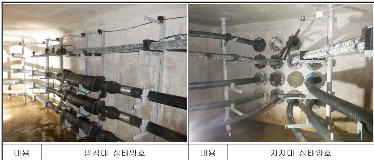
【사진 7.76】 부속 및 부대설비 현황
