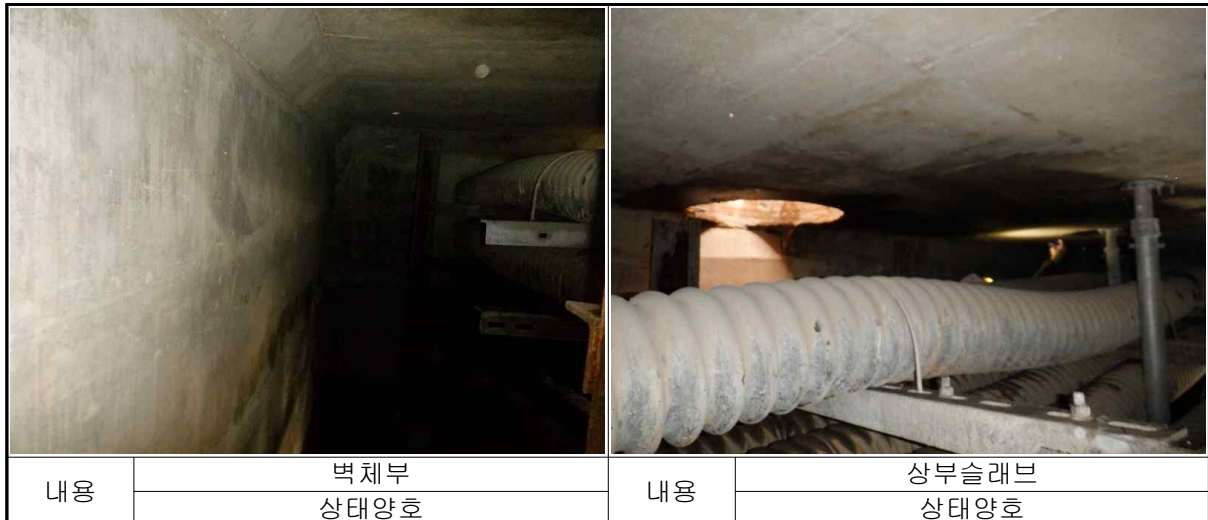
【사진 7.34】 맨홀 내부 주요 손상
