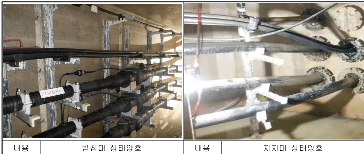
【사진 7.28】 부속 및 부대설비 현황
