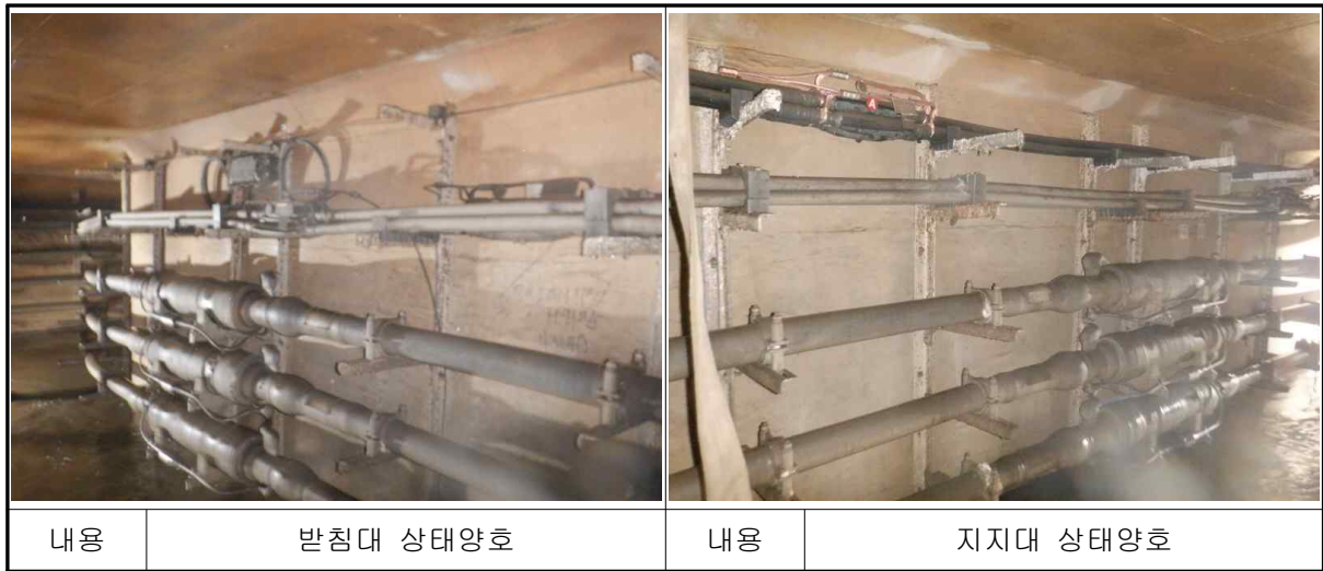
【사진 7.64】 부속 및 부대설비 현황
