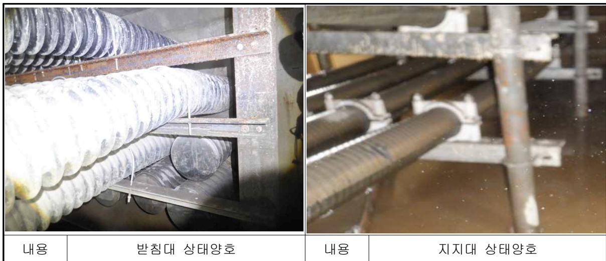
【사진 7.32】 부속 및 부대설비 현황
