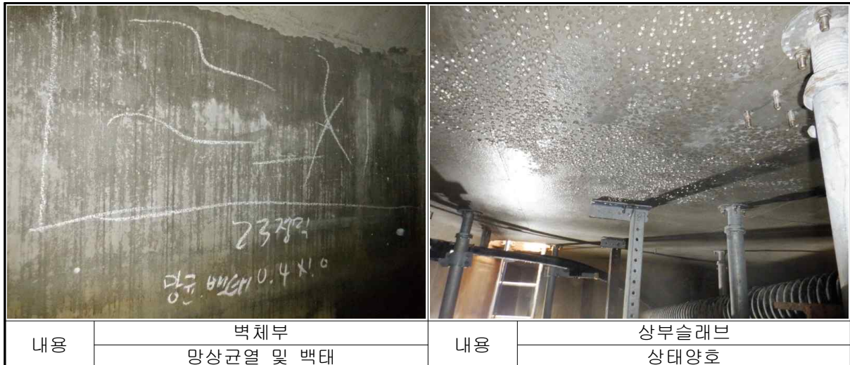
【사진 7.30】 맨홀 내부 주요 손상
