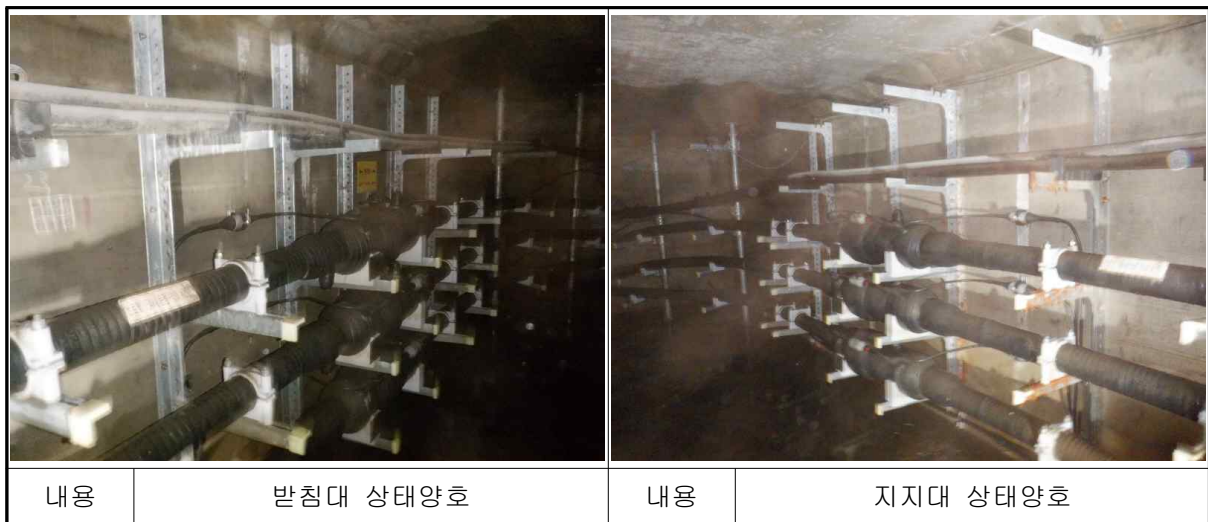
【사진 7.40】 부속 및 부대설비 현황
