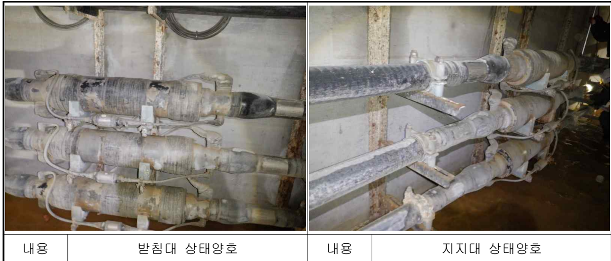
【사진 7.20】 부속 및 부대설비 현황
