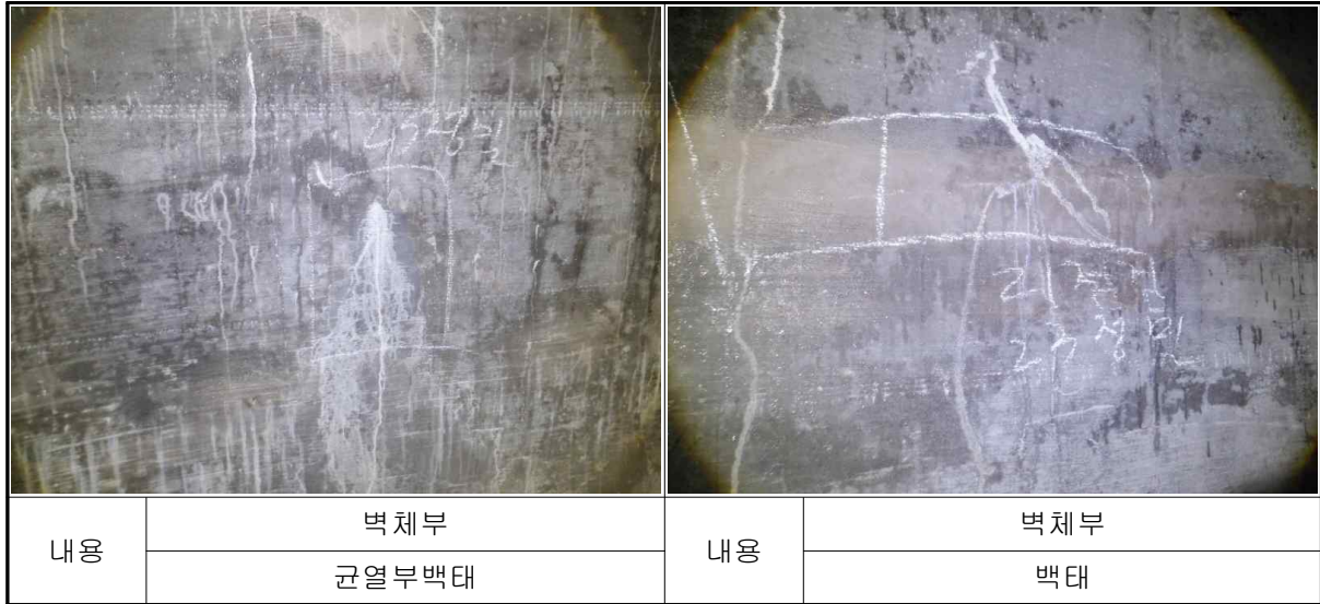
【사진 7.54】 맨홀 내부 주요 손상
